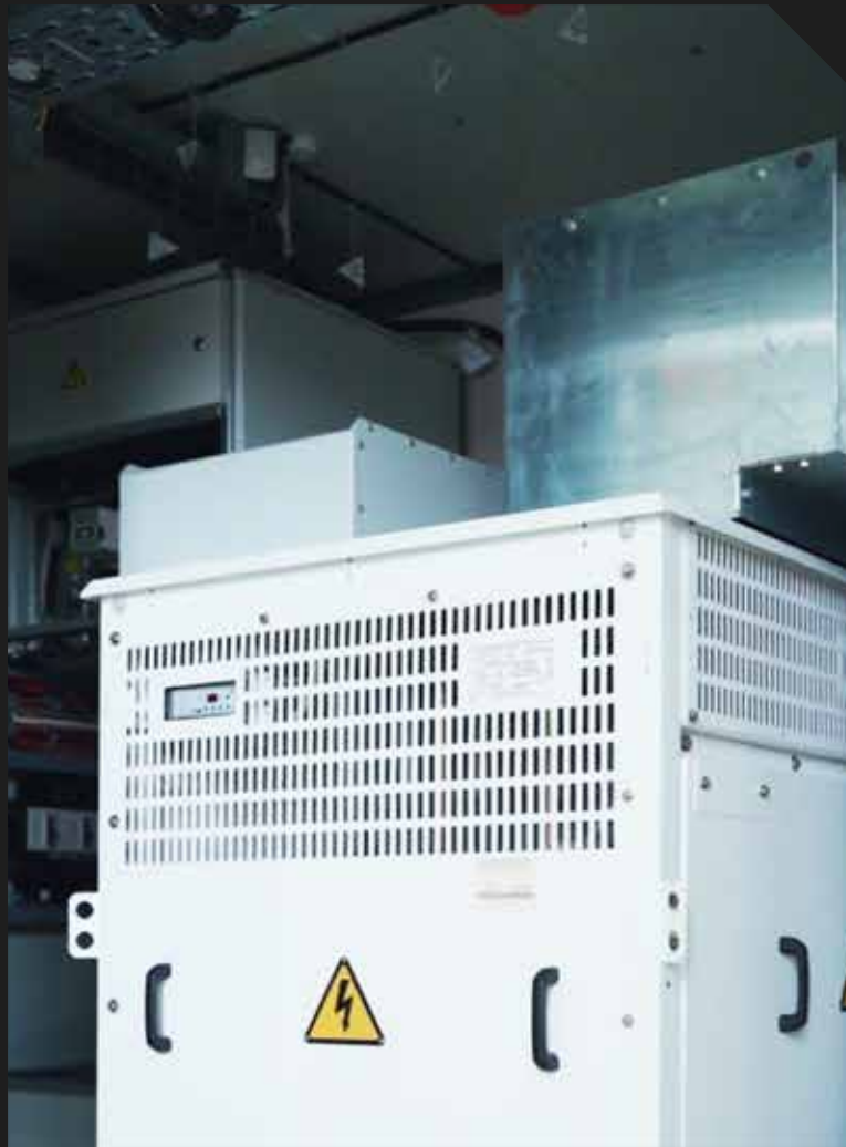
Комплектные трансформаторные подстанции (КТП)
