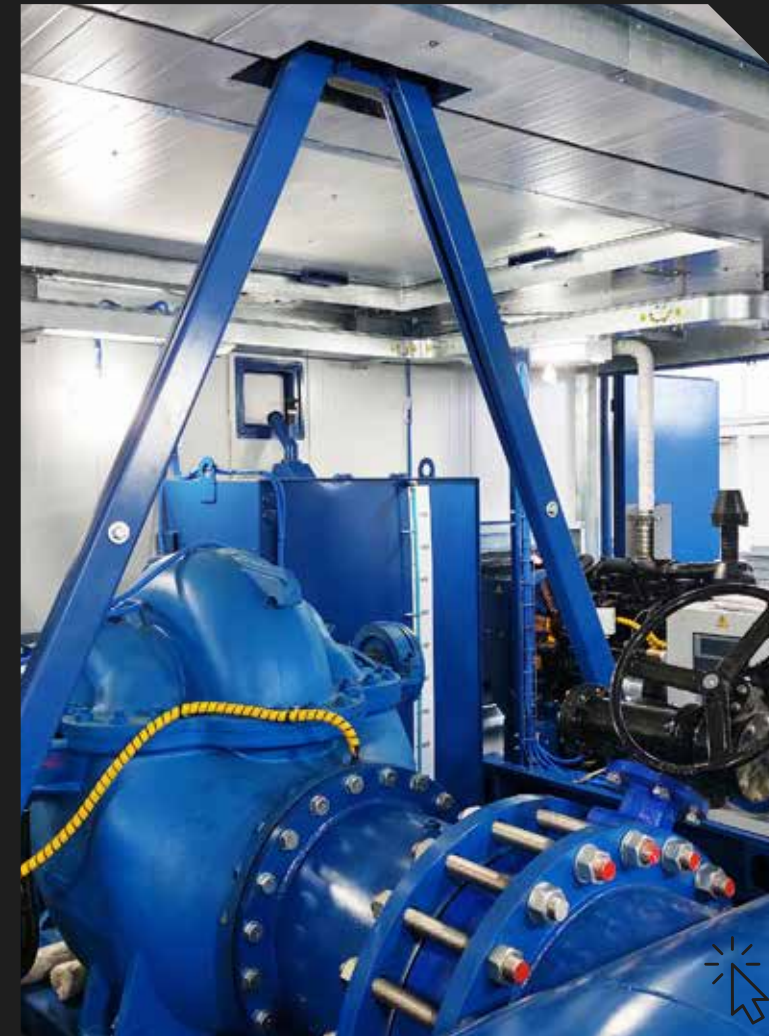
Дизельная насосная установка для золоторудного месторождения
