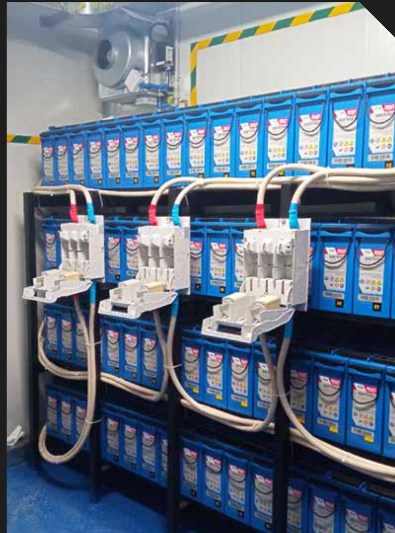
Источники бесперебойного питания (ИБП)
