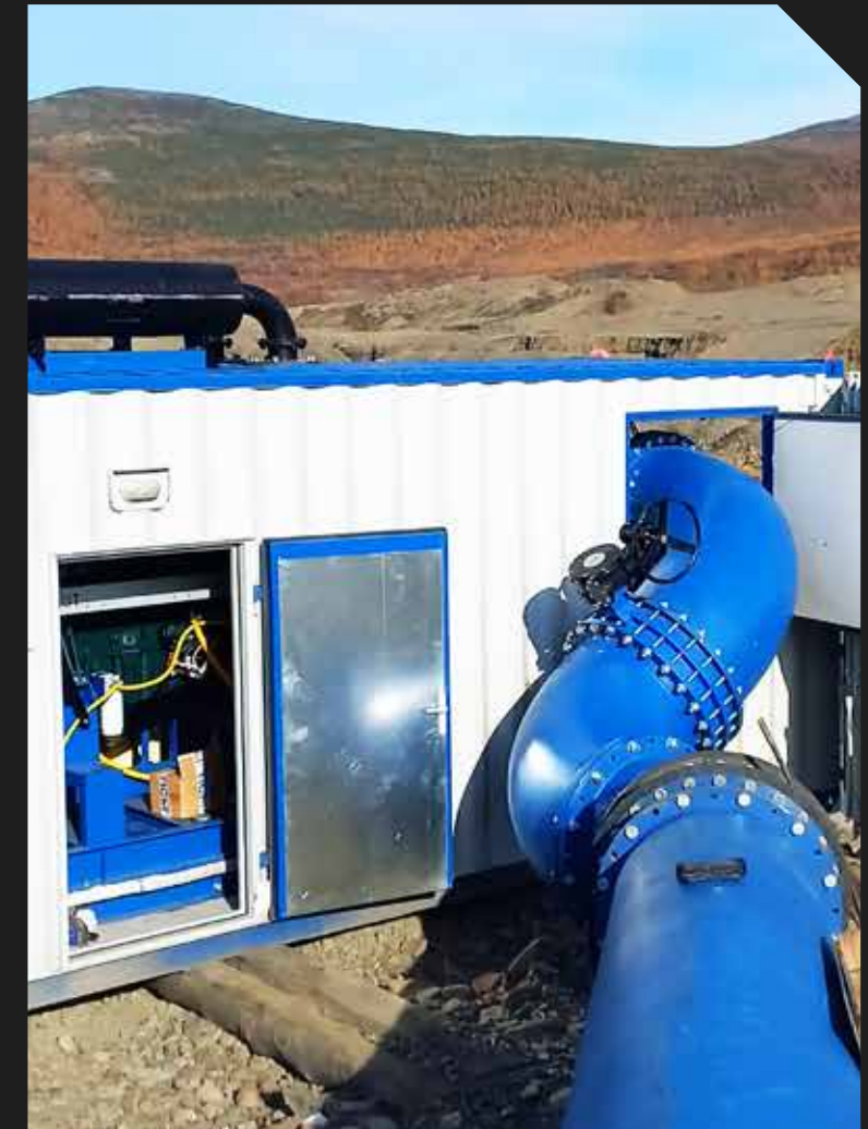
Дизельная насосная установка для золотодобывающей компании
