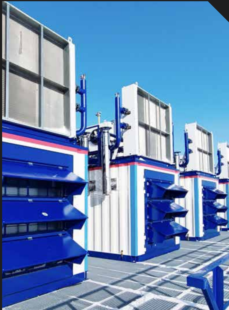
Два энергокомплекса по 4 МВт для НОВАТЭК
