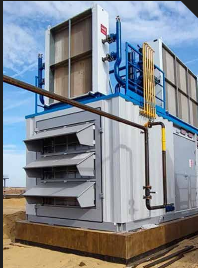
Газопоршневые установки (ГПУ)
