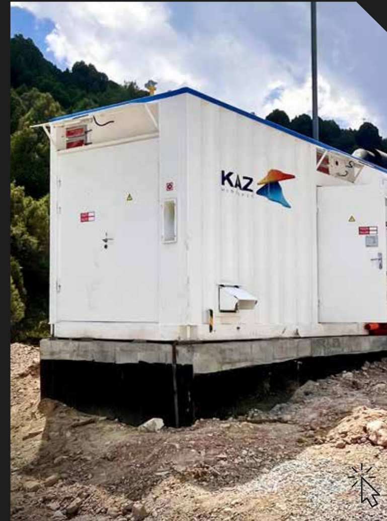
Энергокомплекс 4,5 МВт для подземного рудника в Киргизии
