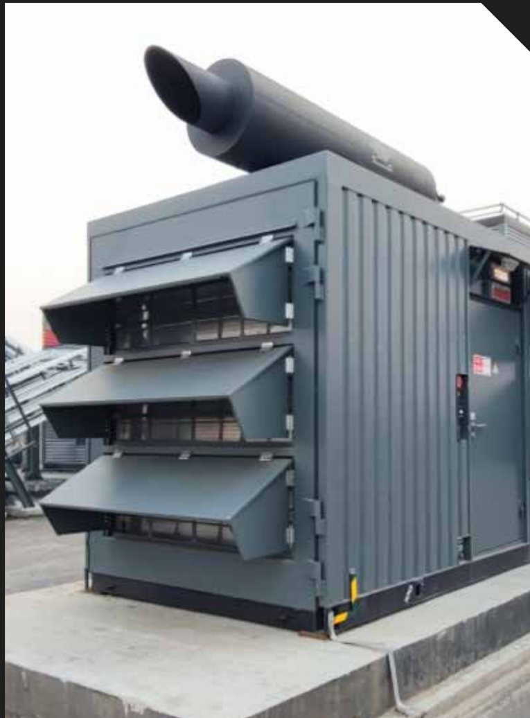
Дизельные электростанции (ДЭС)
